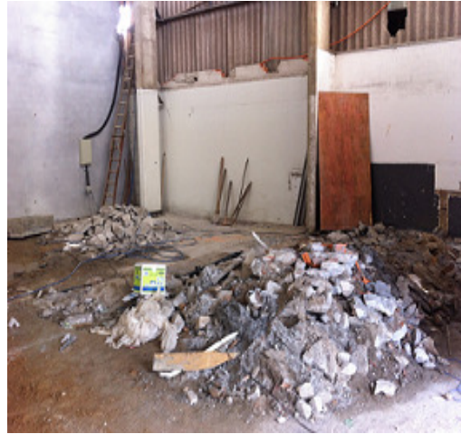
Figura 4 – Materiais não utilizados obra 02
