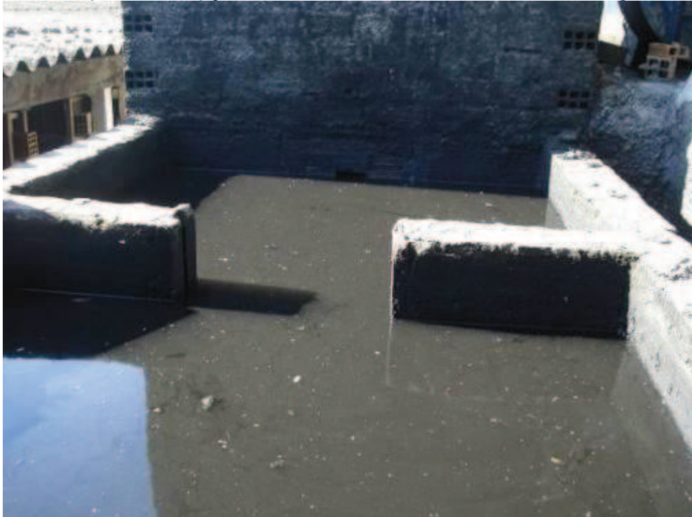
Figura 13: Tanque de recepção dos efluentes oriundos do lavador de gases.
